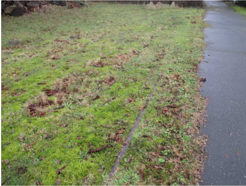
Foto/Abb. 07: überwachsenes Betriebsgleis
